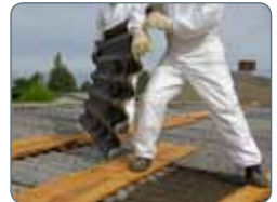
Durch Asbest verursachter Krebs tritt meist erst nach Jahrzehnten auf. Seit 1993 ist der Baustoff in Deutschland verboten.
